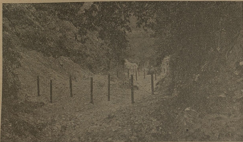
Fot. 14. Corrección de la barranca de "La Bolsa". Iniciación de la construcción de los muros transversales de contención en el curso medio de la barranca, en julio de 1937. Trabajos del F. C. Mexicano, recomendados por el Servicio Forestal Oficial.
