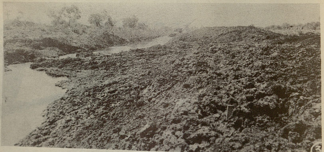
Distrito de Riego de Morelia y Queréndaro, Mich.—Vistas del nuevo cauce del Río Grande de Morelia, en la parte del Valle de Morelia, labrando en medio de ciénagas y pantanos. Por ello ocurrieron numerosos derrumbes, como los que muestran las fotografías. Posteriormente al perder los terrenos, el agua de que estaban suturados, fué posible dar al nuevo cauce (que actúa como dren colector), una sección regular.
