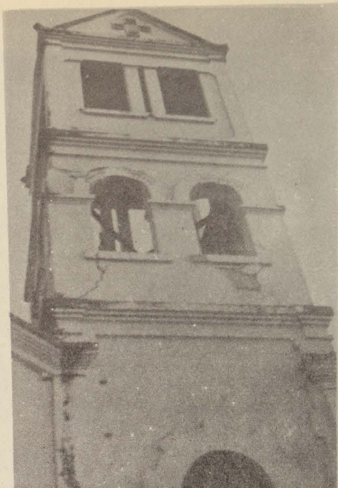
Fig. 14.- Torre derecha de la iglesia de Minatitlán, fracturada en varios puntos debido a la presencia de las campanas y sus soportes.
