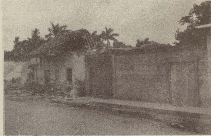
Fig. 8.- A una cuadra del zócalo de Acayucan se observó la falla del techo en esta casa. Es evidente que la armadura de madera era absolutamente inadecuada para soportar la techumbre de tejas.
