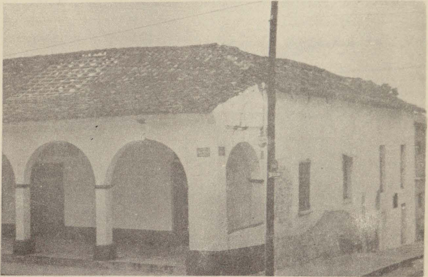
Fig. 34.- Columnas fracturadas, arcos fallados, hundimiento de las tejas y paredes cuarteadas, son los resultados de métodos deficientes y pobre mano de obra en la construcción del Hotel Hidalgo, en Acayucan.
